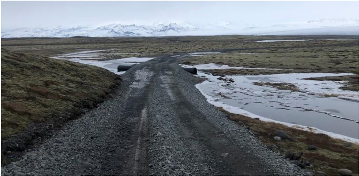
Mynd 71. Ræsi í stöð 2850. Hér hefur slóðin verið byggð upp utan í fláa sem heldur við slóðina, það er ekki að sjá að sama „útvíkkunarferli“ eigi sér stað þarna eins og víða annars staðar á þessari slóð.
